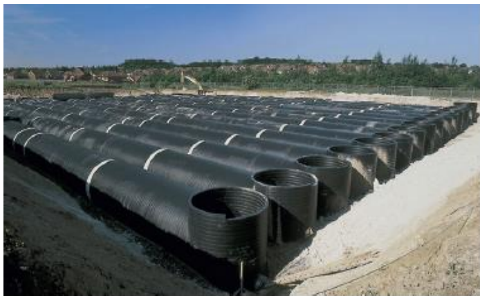
Figur 15. Exempelbild på rörmagasin i plast. Foto: Stockholm Vatten och Avfall
