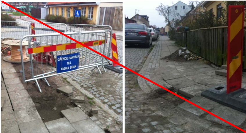
Bild 30 Dåligt avgränsade markarbeten ger en osäker miljö.
