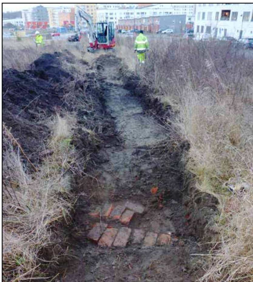
Fig. 8 . Objekt 2, schakt 1. I den norra delen, närmast i bild, påträffades spår av en äldre elledning, ej i bruk, som täckts med tegelstenar. I bakgrunden syns Barkarbystaden.
