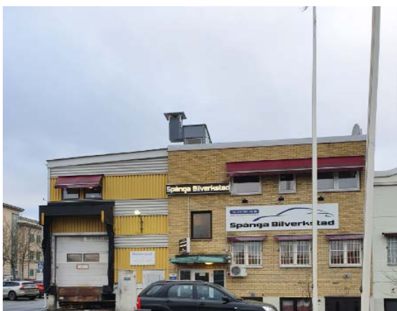
Figur 6. Fläkthuv på taket av Spånga Bilverkstad.
