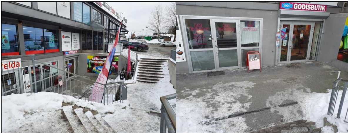
Figur 3-5. Lågpunkten intill byggnadens södra sida. Vänster bild visar trappan ned till källarplan och höger bild visar placering av rännan. Bilder tagna vid platsbesök 2021-02-17.
